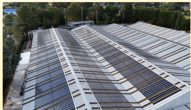
Installationen på taket till Yazaki i Bogotá är 872 paneler och 144 kWp stor.
