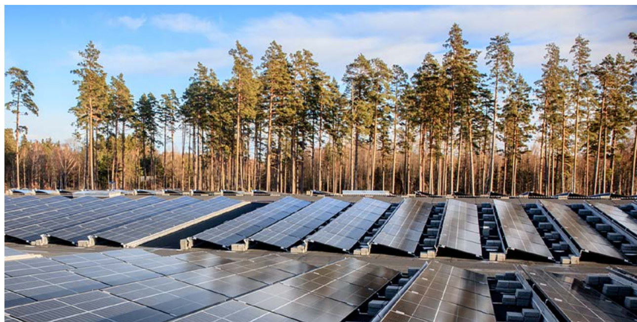
Solpanelerna hos CTT Bribo driftsattes i slutet av 2021 och beräknas producera cirka 200 000 kwh per år.
