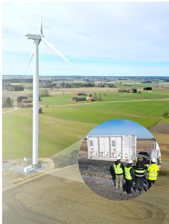
Två Soltechbolag, Provektor och Soltech Energy Solutions, har tillsammans med energibolaget Kvänum Energi installerat och driftsatt tre batteriinstallationer om sammanlagt 3 MWh i anslutning till vindkraftverk. Det skapar en hybridlösning som lagrar överskottsel och stabiliserar elnätet.
