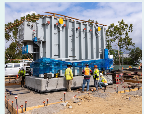
Leverans av transformator till projektet.
