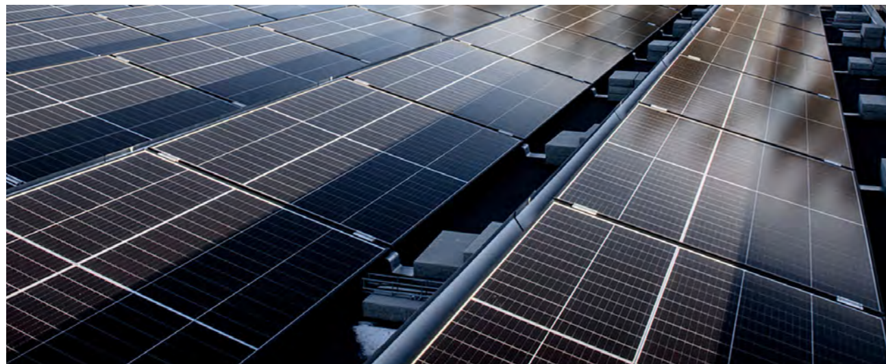
Solpanelerna hos CTT Nybro driftsattes i slutet av 2021 och producerade ca 205 000 kWh under år 2023. Över förväntan som var på 200 000 kWh.
