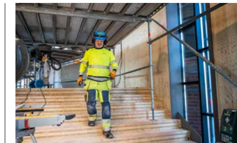
↑ Det stora väderskyddet över ellipsen av trä flyttas i takt med att arbetet fortskrider.
