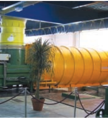
Envac är verksamt inom avfallshantering. Här ses en mottagningsstation i Sevilla, Spanien.
