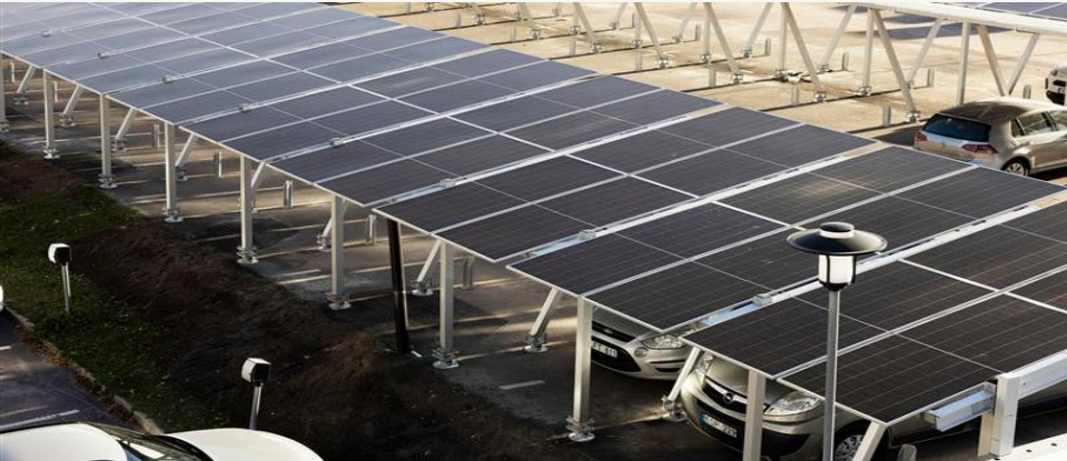
Carportar med solceller vid Scandic Luleå
