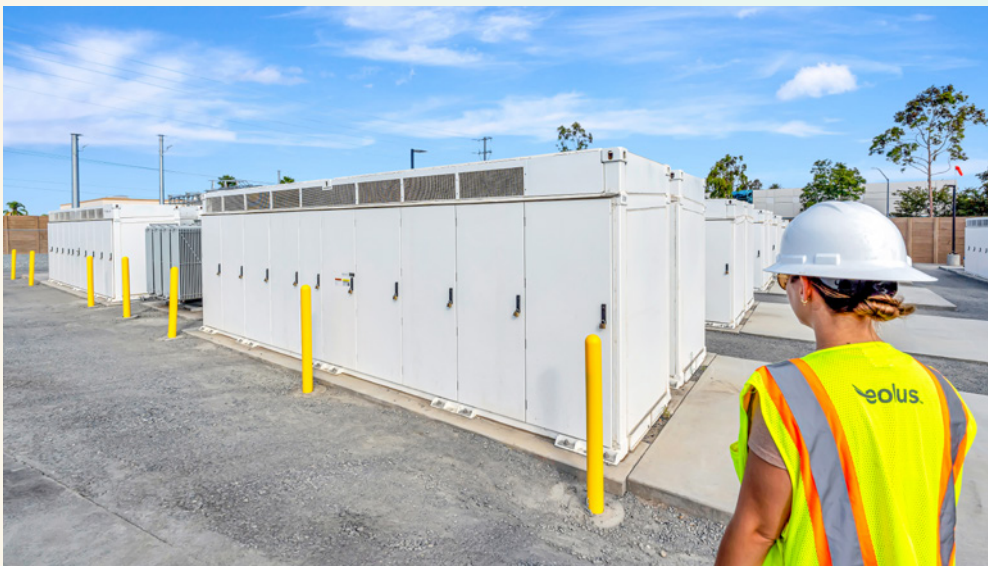
Batteriprojektet Pome i San Diego-området färdigställdes under 2025. Läs mer om projektet på sidan 36.
