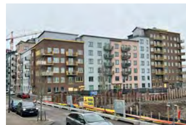
Parstugan, Ursvik Sundbyberg, 200 hyresrätter och lokaler i entreplan, köpare CBRE IM
