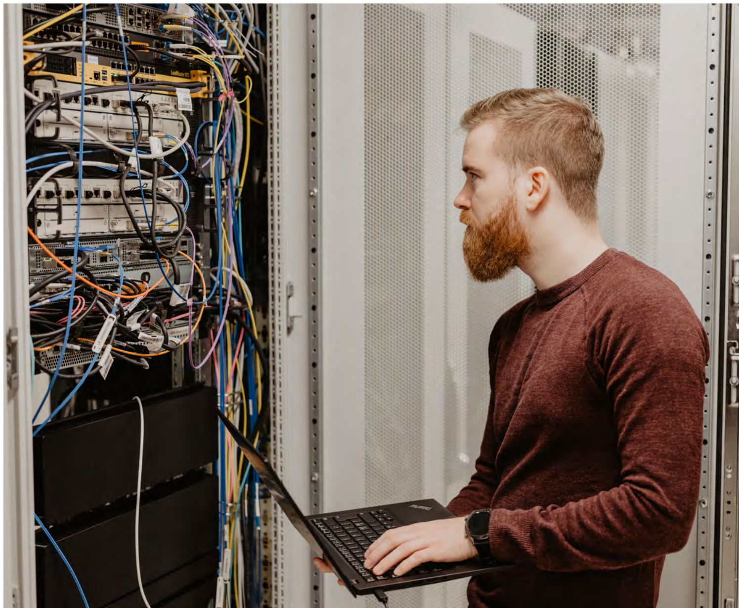
▶ Stefan Westergren, infrastrukturtekniker på Vitec IT-drift, i en av Vitecs datacenter.
