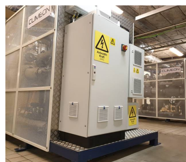
Climeon har utvecklat och levererat två ångturbiner till Viking Lines nybyggda fartyg Viking Glory.
