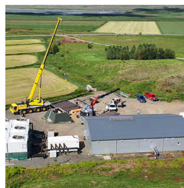
Climeon-modulerna i Varnaorkas kraftverk i Fludir har under 2020 haft en tillgänglighet på 98,3 procent, väl över målsättningen.
