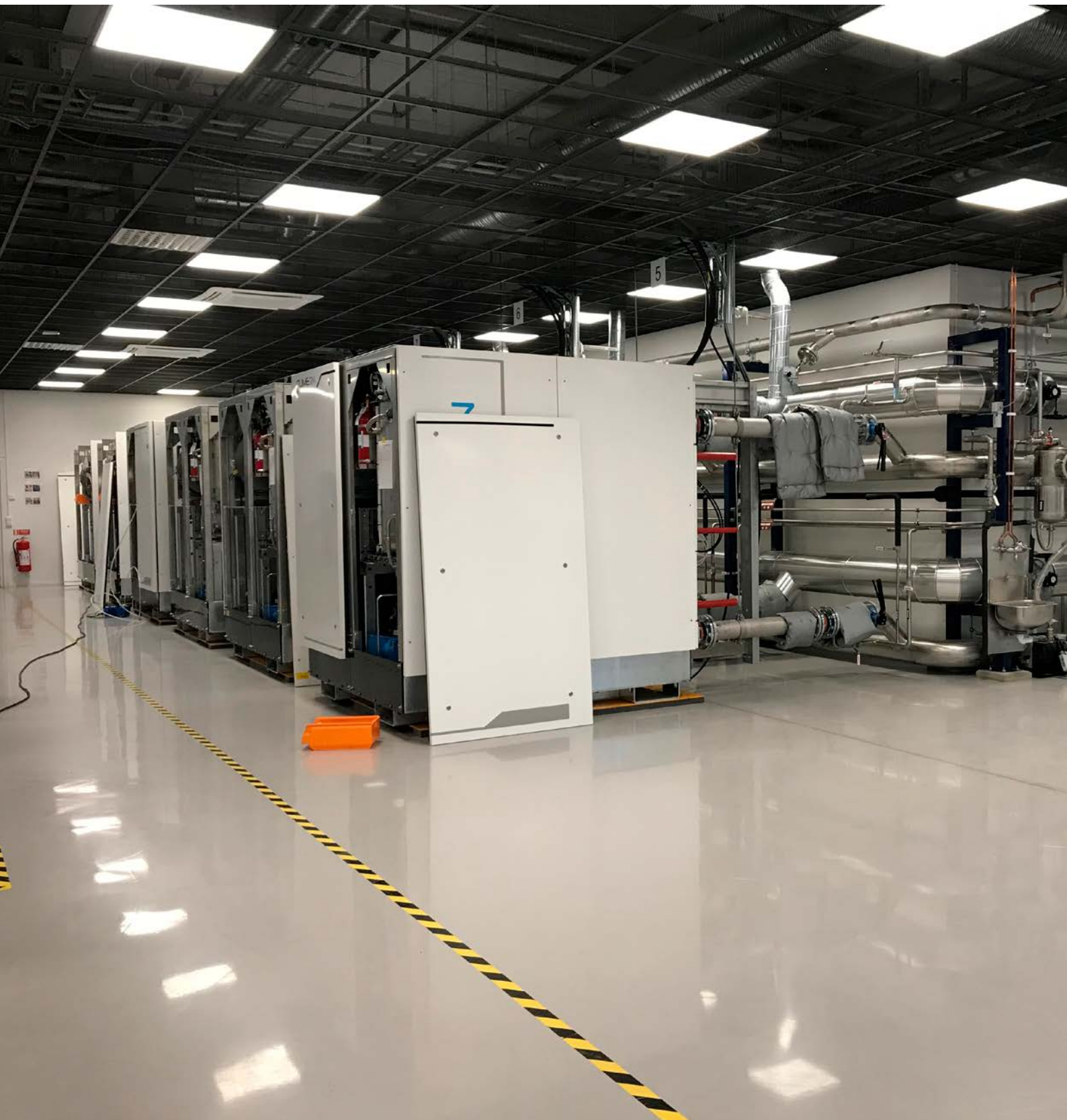
På Climeons test- och utvecklingsanläggning finns plats för tio Heat Power-moduler.
