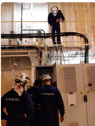
Climeons team slutför arbete med Heat Power systemets elskåp.
