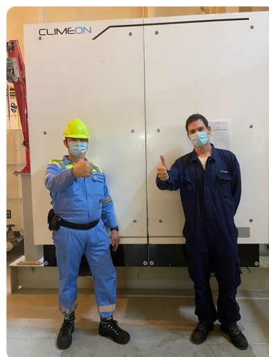
André Liljegren, Climeons Delivery Project Manager tillsammans med Dick Jan Kuijt, Fleet Superintendent, som besökte fartyget i Trieste för att inspektera installationen.
