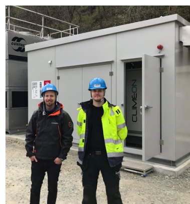
I april driftsattes den första installationen i Japan. Heat Power-modulen återvinner spillvärme från ett större geotermiskt kraftverk.
