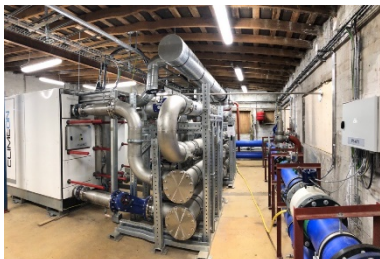
Climeons Heat Power-moduler i Varmaorkas kraftverk, Reykholt på Island.
