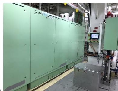
Climeon Heat Power-system ombord på Virgin Voyages fartyg.
