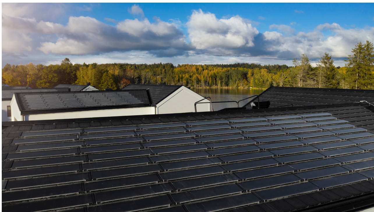
Soltech ShingEl och Soltech Roof på Glasberga villaområde i Södertälje
