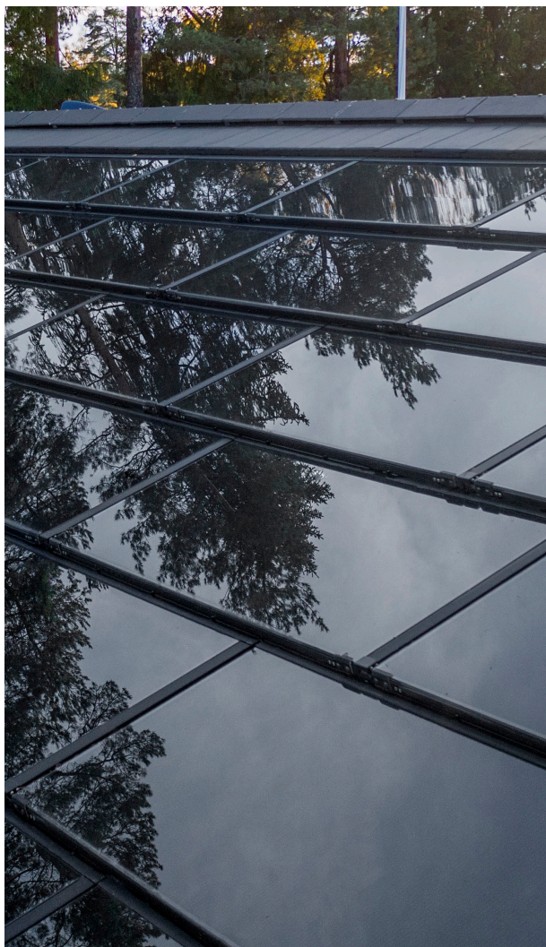
Närbild på Soltech RooF monterad på en Villa i täby.
